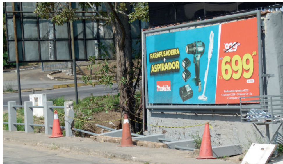
Dias depois da reinauguração, gradil de proteção da ponte do DER foi danificada por um veículo desconhecido
